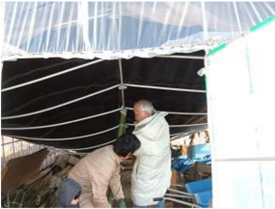
大雪で倒壊したビニールハウスの補強
